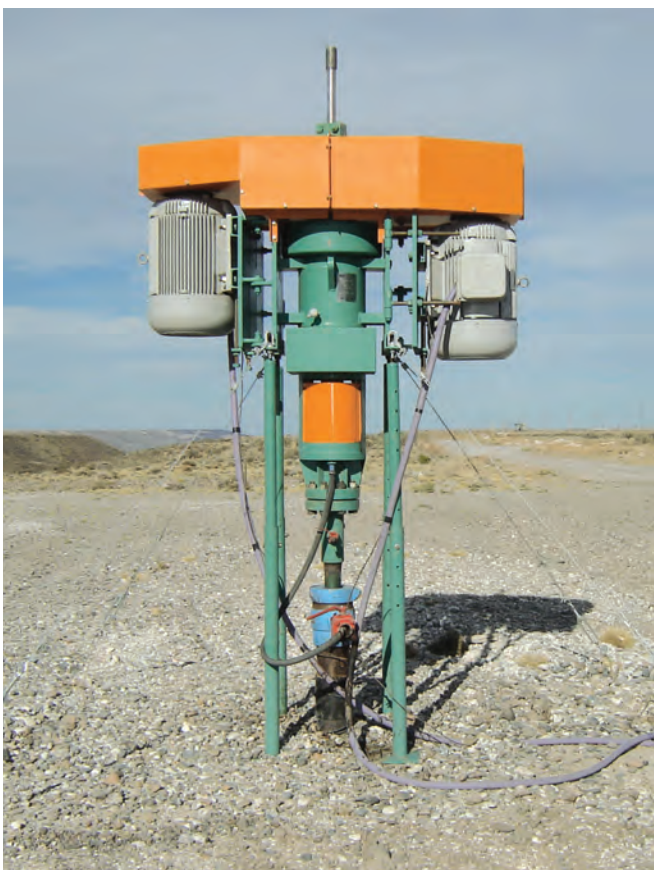
◀ Cabezal para bombeo por cavidades progresivas.
